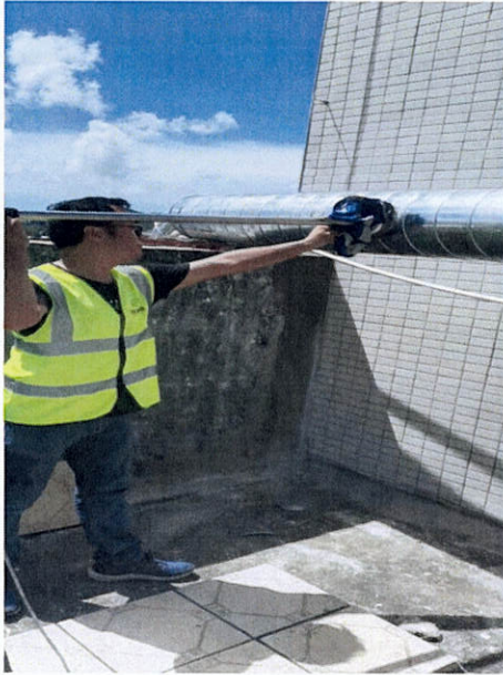
厨房废气处理前采样口
