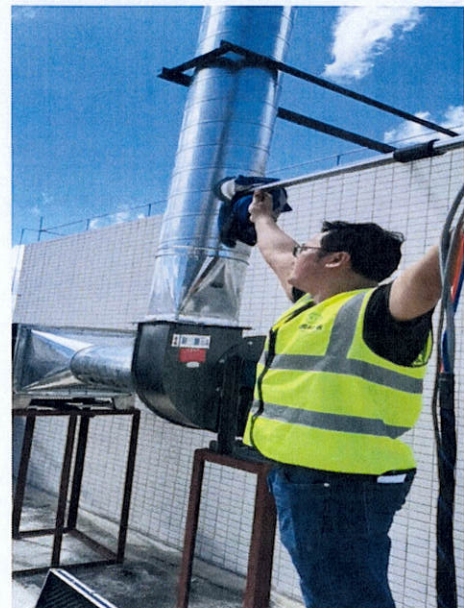
有机废气处理后采样口
