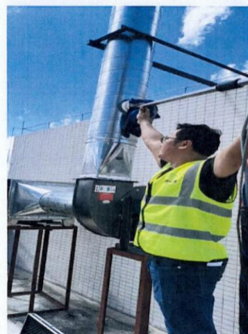
有机废气处理后采样口
