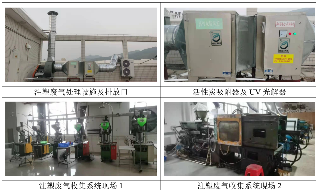
图 3-3 项目有机废气处理设施现场图
