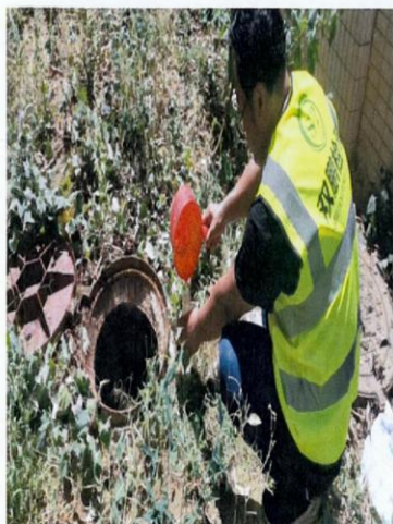
生活污水处理后采样口
